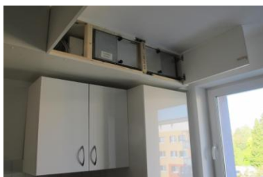
Offene Revisionsklappe der Lüftungsanlage in der Küche und...
