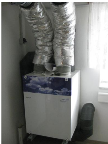
Lüftungsanlage im Erdgeschoss mit Zuluft/Abluft (silber) und Außenluft/Fortluft (schwarz)
