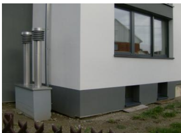
Die Außenluft für die Lüftungsanlagen wird über zwei Erdreichwärmetauscher vorgewärmt
