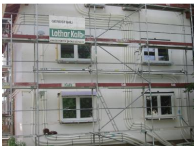
Lüftungskanäle zwischen Bestandswand und (noch fehlender) Dämmung
