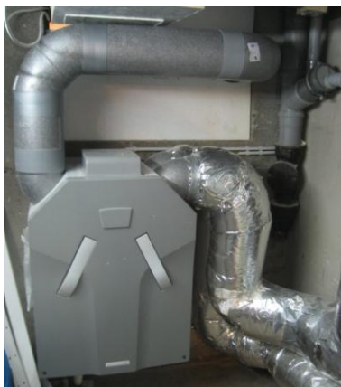
Lüftungsanlage mit Wärmerückgewinnung im Kellergeschoss
