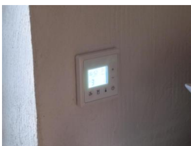
Bedienelement der Lüftungsanlage in der Küche
