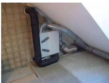
Zentrale Lüftungsanlage im Dachgeschoss
