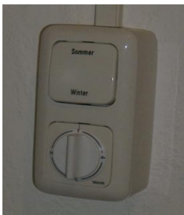
Bedienschalter der Mieter für den Sommer- und Winterbetrieb und die Intensität der Lüftungsanlage
