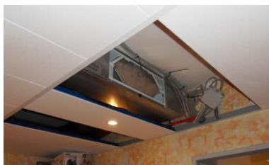
Lüftungsanlage über der abgehängten Decke im Flur mit offener Revisionsklappe
