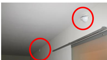
Weitwurfdüsen zur Verteilung der Frischluft im Raum
