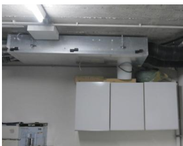
Lüftungsgerät an der Decke im Kellergeschoss
