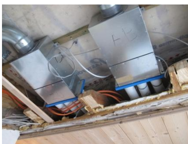
Luftverteiler in der abgehängten Holzbalkendecke
