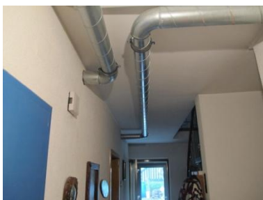
Lüftungskanäle unter der noch nicht abgehängten Decke
