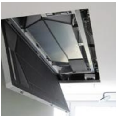
Geöffnete Revisionsklappe der Lüftungsanlage in der abgehängten Decke
