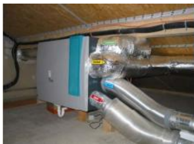
Lüftungsanlage im Dachgeschoss
