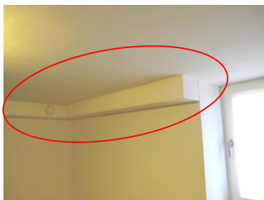
Abgekofferte Lüftungskanäle im modernisierten Kellergeschoss
