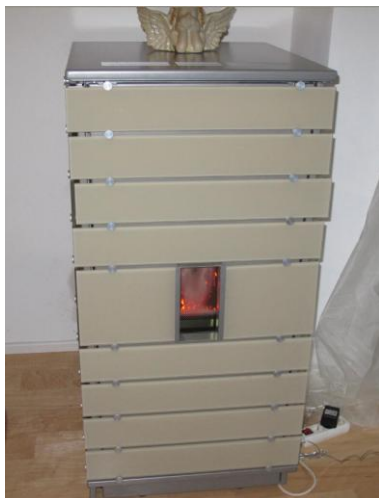
An den Pufferspeicher angeschlossener Pelletofen
