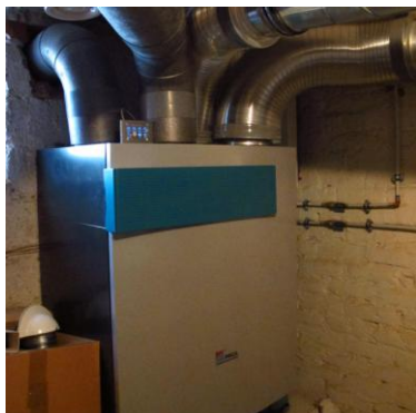
Lüftungsanlage im Kellergeschoss
