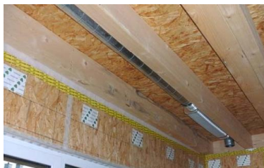
Lüftungskanal in der noch offenen Holzbalkendecke
