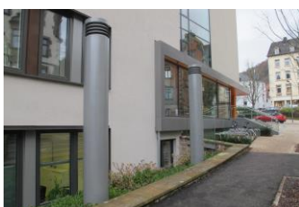
Außen- und Fortluftstutzen einer kontrollierten Lüftungsanlage
