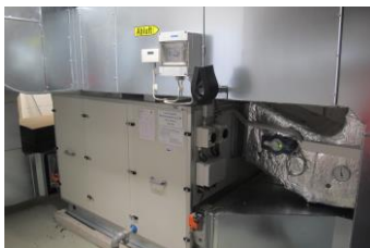
Aggregat der zentralen Lüftungsanlage
