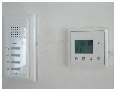
Bedienelement der Lüftungsanlage neben der Türsprechanlage im Flur
