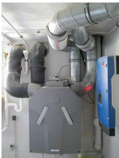
Lüftungsanlage im Keller-geschoss
