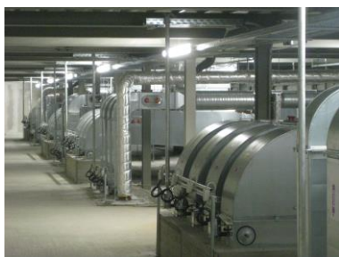
Lüftungsverteilung im Technikgeschoss
