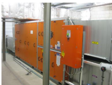
Lüftungsaggregat im Technikgeschoss
