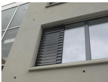
Fenster-Kippflügel für die nächtliche Auskühlung mit Lamellen als Einbruchschutz
