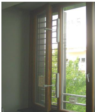
Fensterflügel zur freien Kühlung
