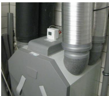
Einfaches Bedienelement positioniert auf der Lüftungsanlage
