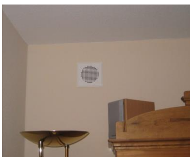
Zuluftventil im Wohnzimmer
