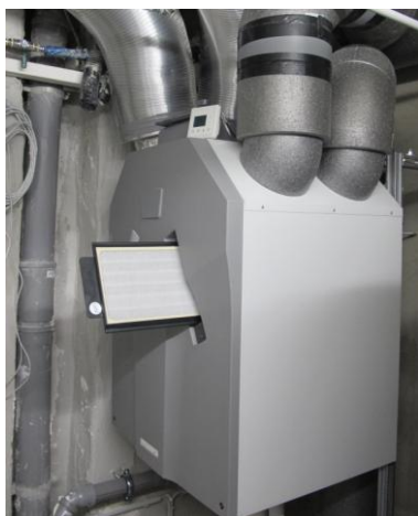
Lüftungsanlage mit herausgezogenem Filter
