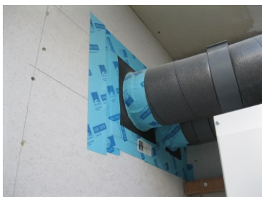
Dichtmanschetten an Außen- und Fortluftkanal
