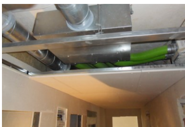
Luftverteilung der Lüftungsanlage in der abgehängten Decke im Wohnungsflur
