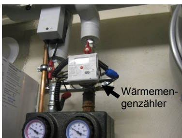
Wärmemengenzähler zur Messung des Heizwärmeverbrauchs
