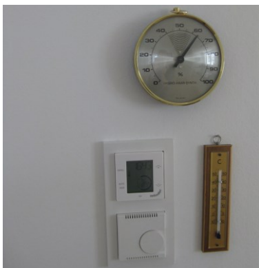
Bedienelement der Lüftungsanlage im Wohnzimmer
