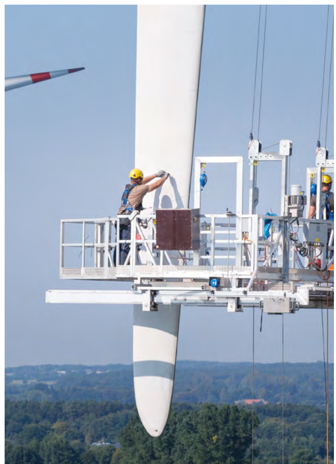
Die Betreiberinnen bzw. Betreiber sind für den ordnungsgemäßen, betriebssicheren Zustand der Anlage verantwortlich.
